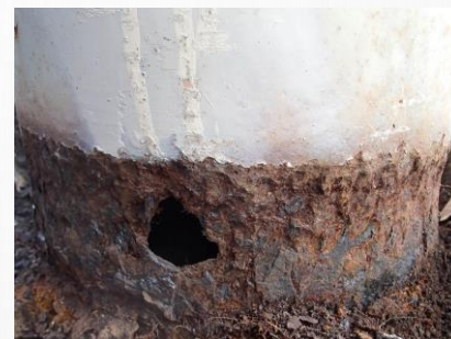
支柱埋設部の錆による腐食
